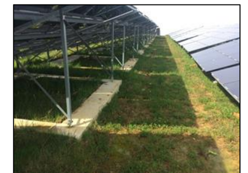
Reprise végétale sous les panneaux photovoltaïques
